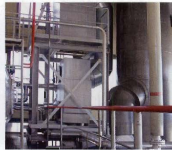
Von links nach rechts: Dampfkessel mit Economiser und Rauchgaskondensator, Dampfkessel vor Umrüstung, Rauchgaskondensator und Economiser
