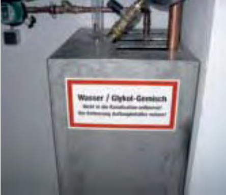
Abb. B.3.5-10 Auffangbehälter
