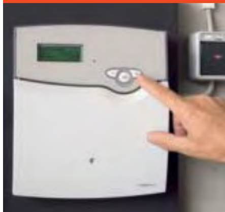
Abb. E.1.3-3 Inbetriebnahme des Reglers
